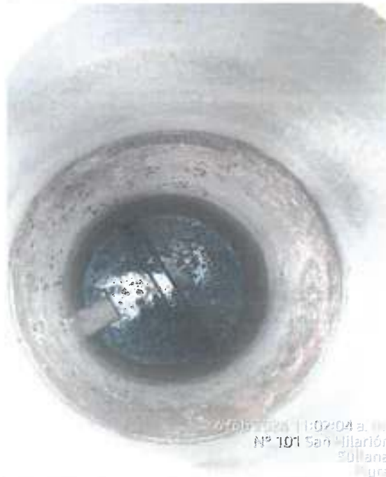
Se verifica buzón con desperdicios adentro
