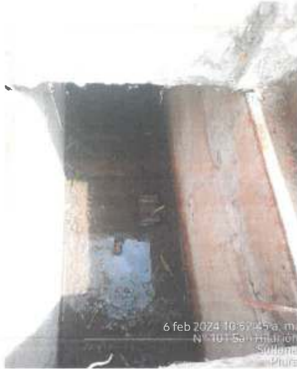
Se verifica canaleta con basura adentro.
