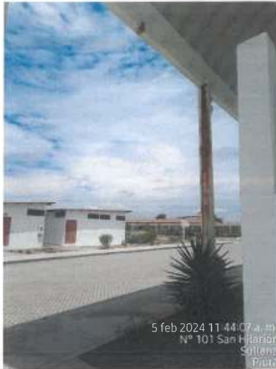
Se verifica la canaleta de acero en estado de oxidación
