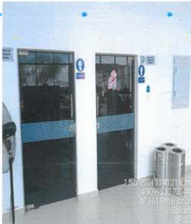
Se verificó suciedad en las puertas de vidrio de los laboratorios y oficinas.
