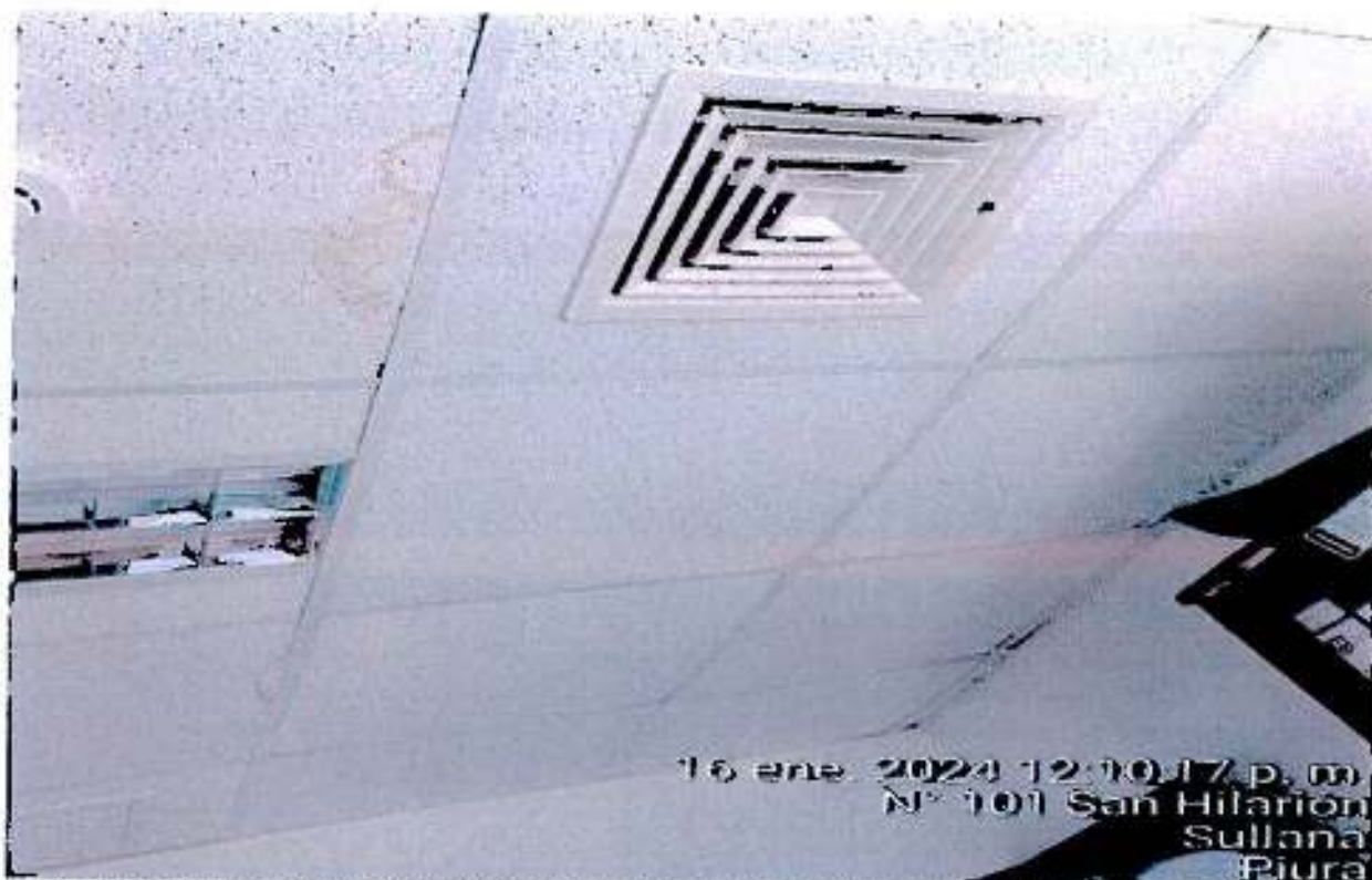
Ilustración 27. SERVICIO DE MANTENIMIENTO PREVENTIVO DE LOS AIRES ACONDICIONADOS DEL PARQUE TECNOLÓGICO
