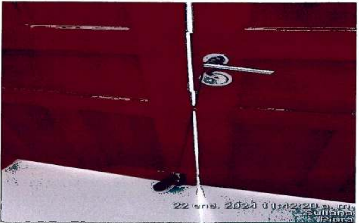
Ilustración 13. SERVICIO DE MANTENIMIENTO DE CHAPAS DE PUERTAS Y MAMPARAS DE LABORATORIO DE BIOTECNOLOGIA MOLECULAR DE LA UNF
