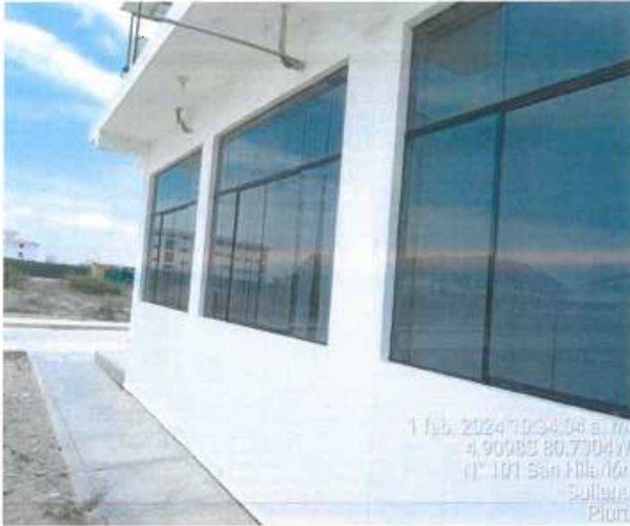
Se verificó suciedad en las ventanas de la parte externa de parque tecnológico
