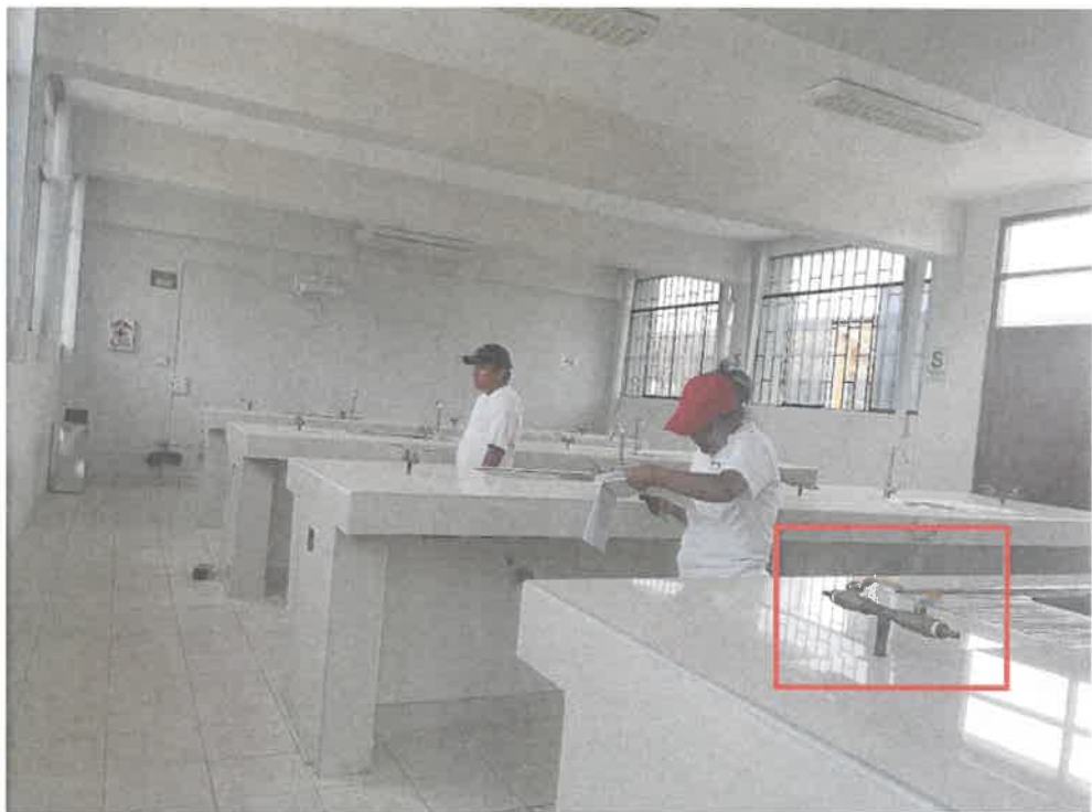
Fotografía 10. Conexiones de gas (Riesgo de explosión por fuga de gas).
