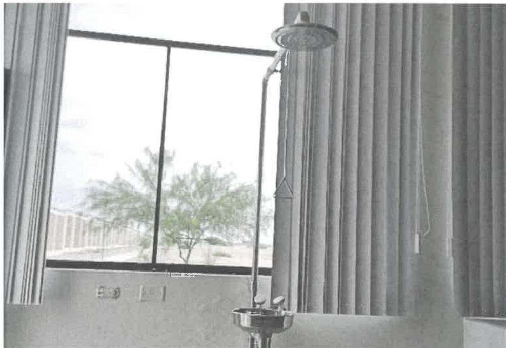
Fotografía 22. Ducha de emergencia
