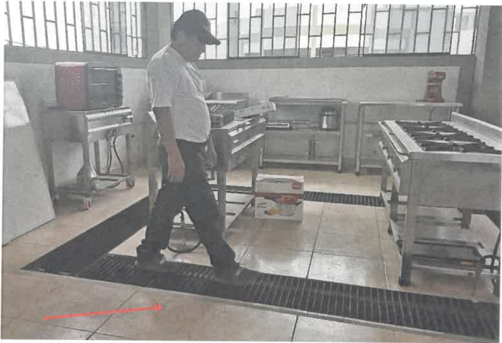
Fotografía 29. Rampas inestables (Riesgo de caídas)
