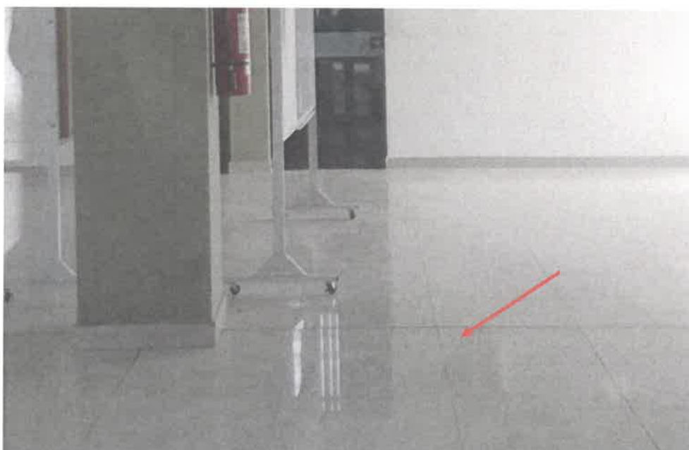
Fotografía 18. Piso resbaladizo, ausencia de rampas de drenaje (Riesgo de caída)
