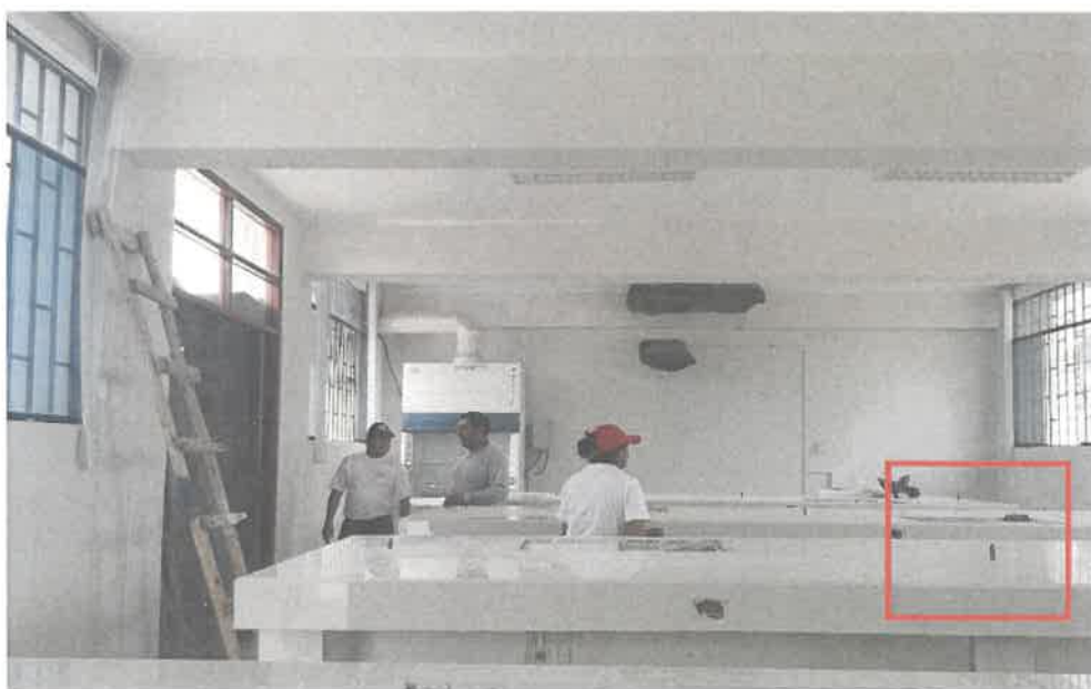
Fotografía 2. Conexiones a gas (Riesgo de explosión por fuga de gas).
