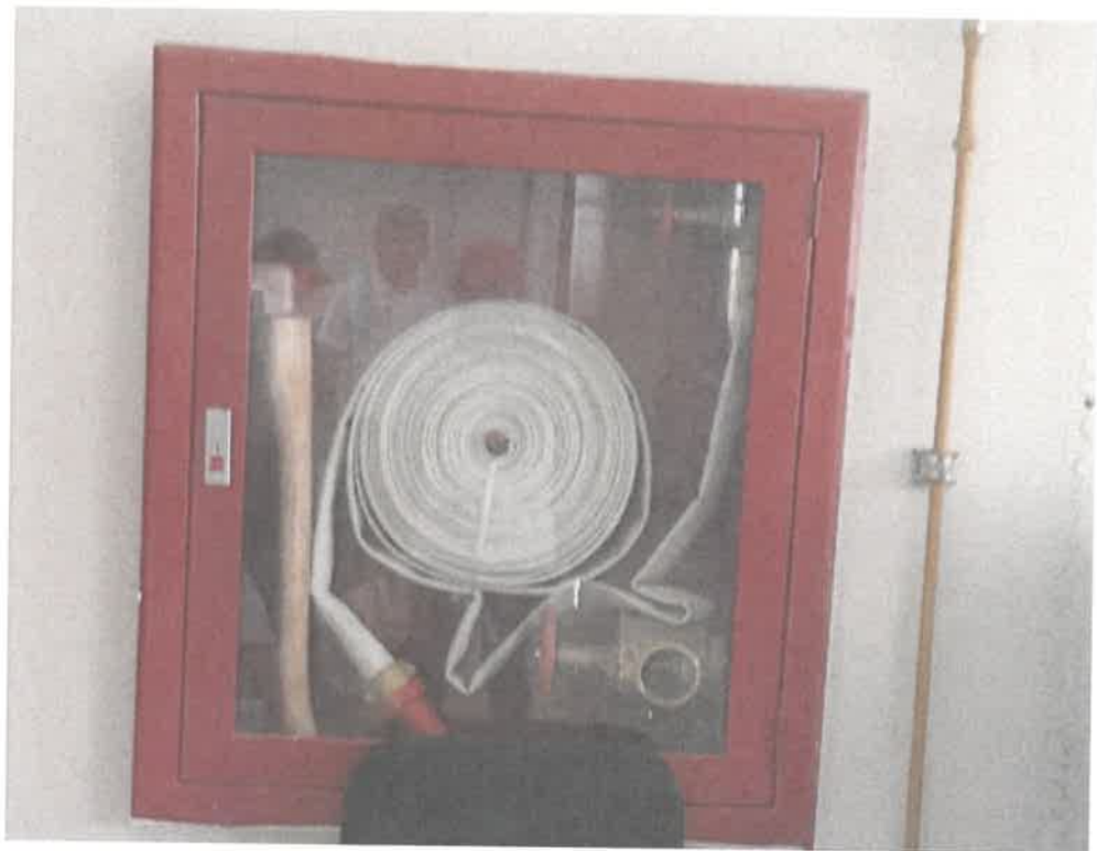
Fotografía 32. Manguera contra incendios.
