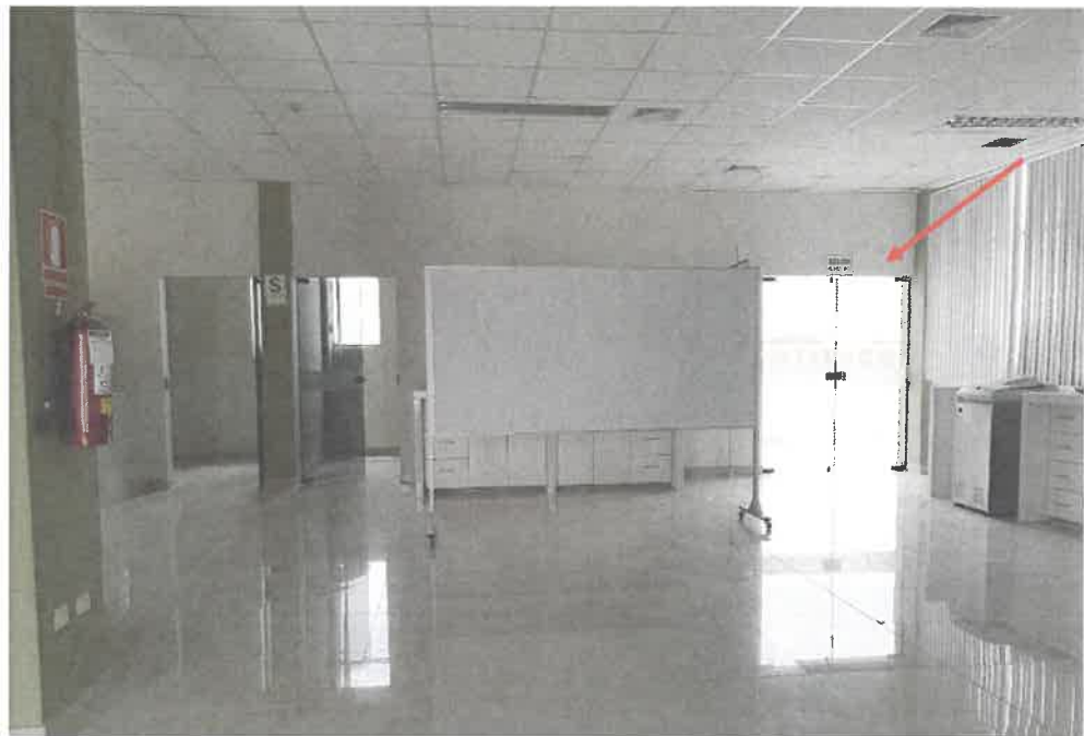
Fotografía 16. Salida de emergencia.
