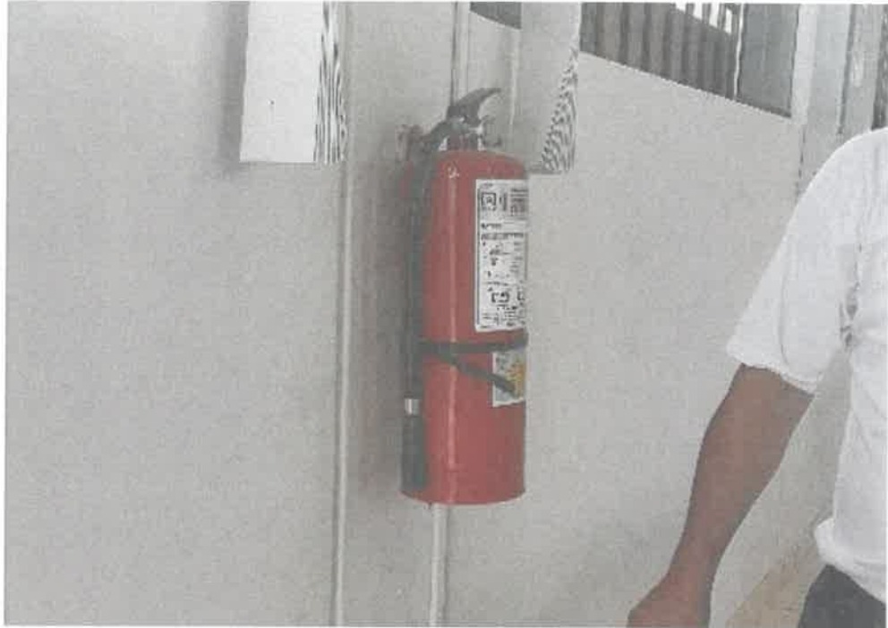
Fotografía 11. Extintor de fuego.
