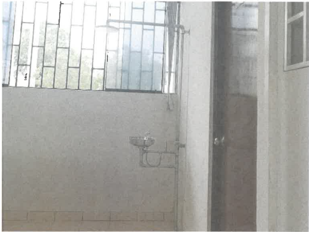
Fotografía 7. Ducha de emergencia.
