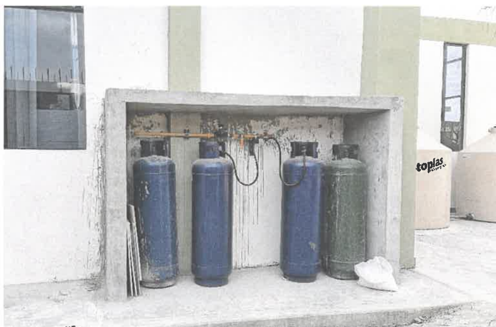
Fotografía 20. Balones de gas semi protegidos, exposición a humedad y radiación solar (Riesgo de explosión, incendio).
