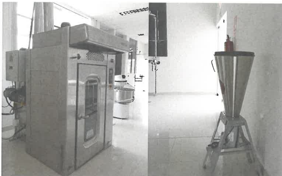
Fotografía 17. Disposición de equipos: Horno, amasadora, licuadora industrial (Riesgo eléctrico)
