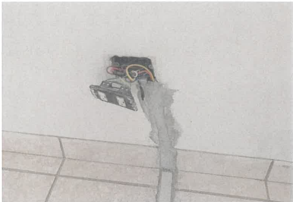
Fotografía 6. Red de cables en mal estado (Riesgo eléctrico).
