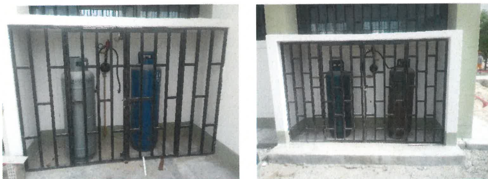
Imagen N° 13: Vista almacenamiento de cilindros en la UNF
