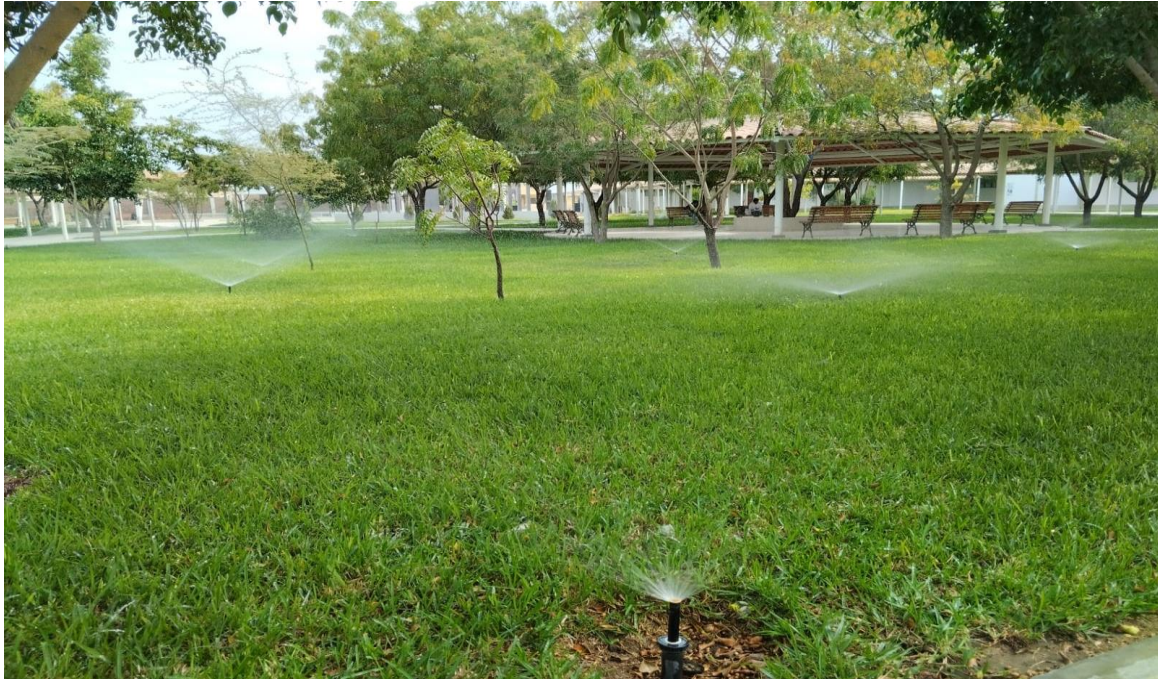
Imagen 3. Riego presurizado de las áreas verdes del campus universitario
